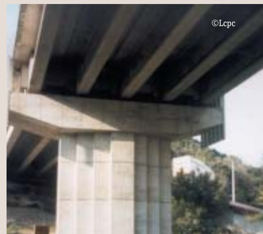
VUE GÉNÉRALE D'UN PONT PRÉSENTANT LES SYMPTÔMES D'UNE RÉACTION SULFATIQUE LOCALISÉE AU NIVEAU DU CHEVÊTRE
